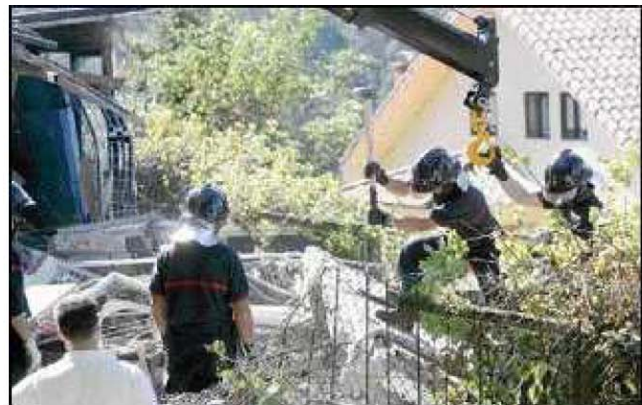
Bomberos retiran los escombros de la estación de telefonía móvil de Valladares. / José Iores
